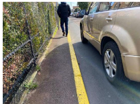
Rue Anatole France (trottoir < à 1,40 m)
